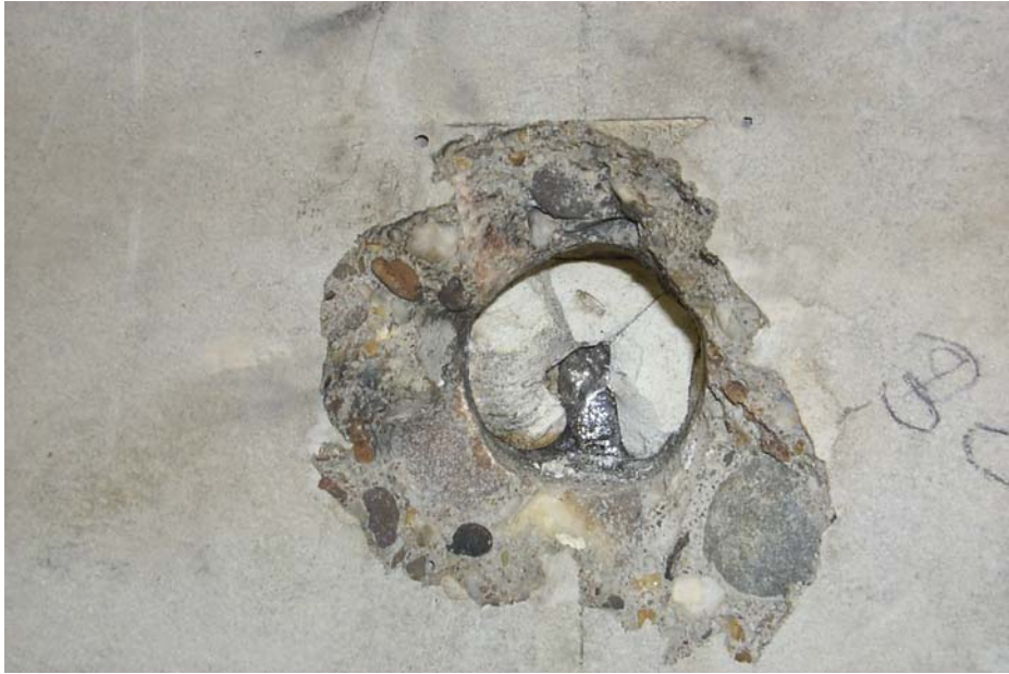
Bild 13: Anschlussvariante „I“: Zerstörter Prüfling I.5 nach der Prüfung.
