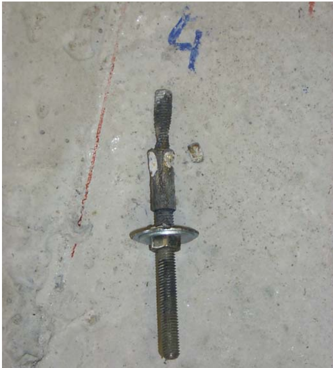
Bild 11: Gewindestange mit Metalldübel bei seitlicher Kontaktierung (Anschlussvariante „0b“) nach der Prüfung (Prüfling D4).
